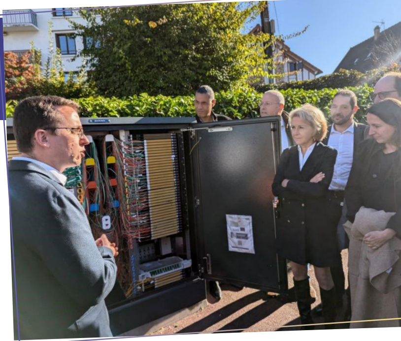
↑ Visite terrain autour d'une armoire fibre optique.
