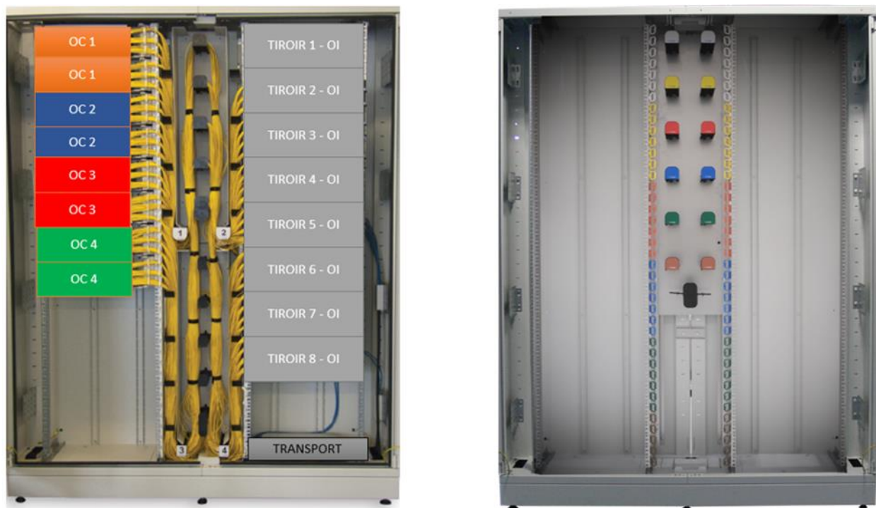
Armoires « Indoor » 2 x 40U avec zone de brassage en « W » ou « M » et tiroirs de distribution en 4U
