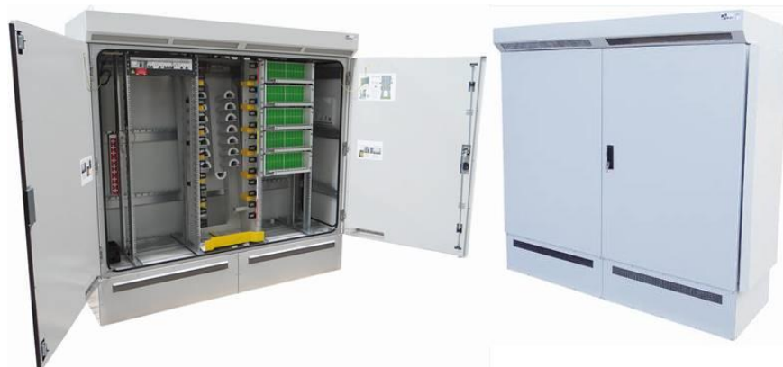
Armoires actives avec panneaux d'ombrage
